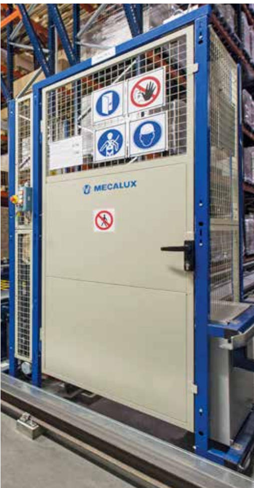
Zugang zu Kontroll- und Wartungsbereichen
